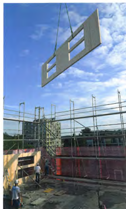
Die Gebäudehülle der Aufstockung wird von 12 cm dicken Brettsperrholz-Elementen gebildet, die auf der Baustelle mineralisch gedämmt wurden.
