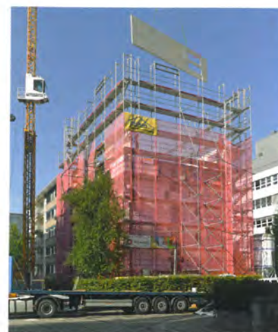
Die Holzelemente der Aufstockung werden angeliefert und sogleich an ihren Platz gehievt.
