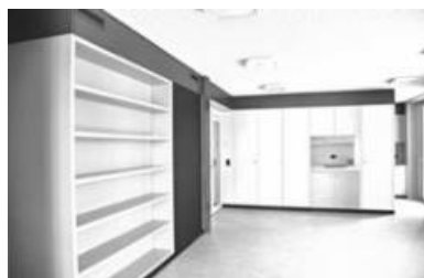
Der Innenbereich des Tagesstern ist auf die Bedürfnisse der Schulkinder abgestimmt. Das Bild zeigt den noch nicht ganz fertig erstellten Innenausbau.
