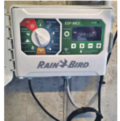
Wetterstationen steuern die Bewässerungsanlage und garantieren für einen bedarfsgerechten Wasserverbrauch.
